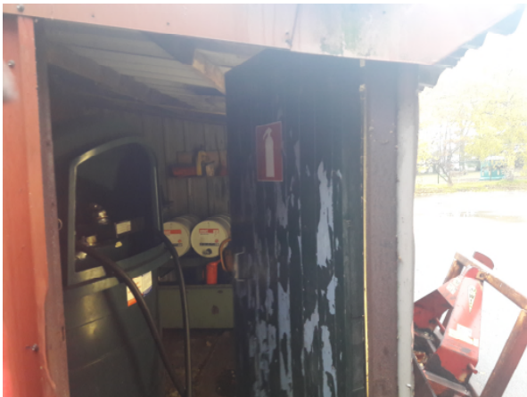
Fotonummer: 9 Omschrijving: Detail bovengrondse tank (1)
