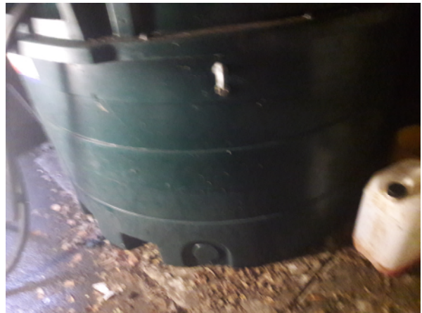
Fotonummer: 10 Omschrijving: Detail bovengrondse tank (2)
